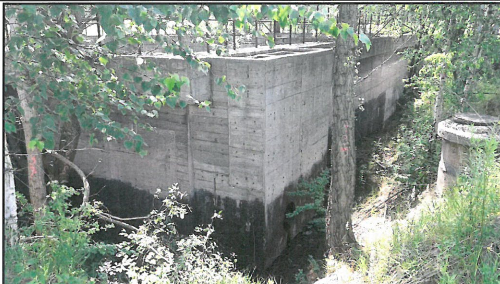
Fot. 3. Widok na osadnik betonowy
