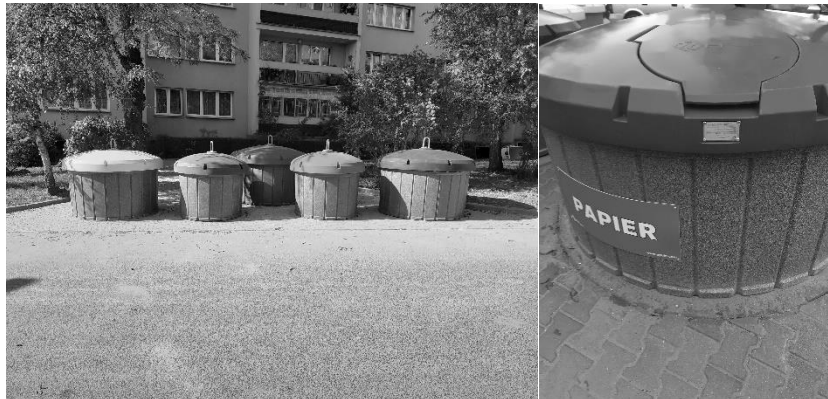
Fot. 5. Pojemniki półpodziemne na jednym z krakowskich osiedli (źródło własne).
